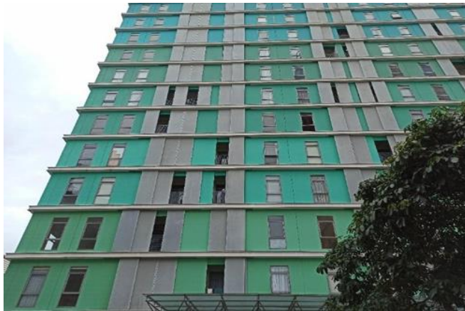
Gambar 11. Perubahan Fasad pada Tampak Bangunan Sumber: Survey Lapangan (2021)
