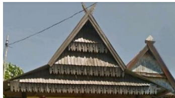
Gambar 16. Celah pada atap sampel 5 Sumber: Google Maps
