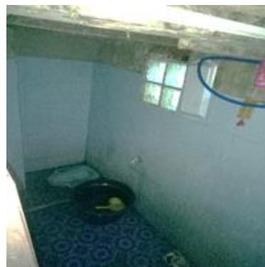
Gambar 2. Kondisi Kamar Mandi Sumber: Dokumentasi pribadi, 2021
