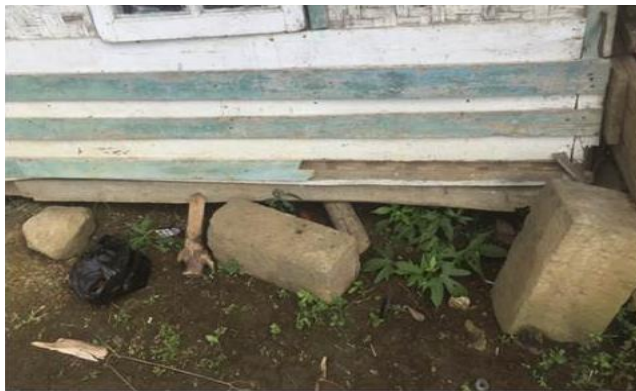
Gambar 5. Setelah terjadi gempa, terdapat bangunan yang tidak kembali tepat di atas umpak, sehingga kemudian bangunan diangkat untuk diletakkan kembali di atas umpak
